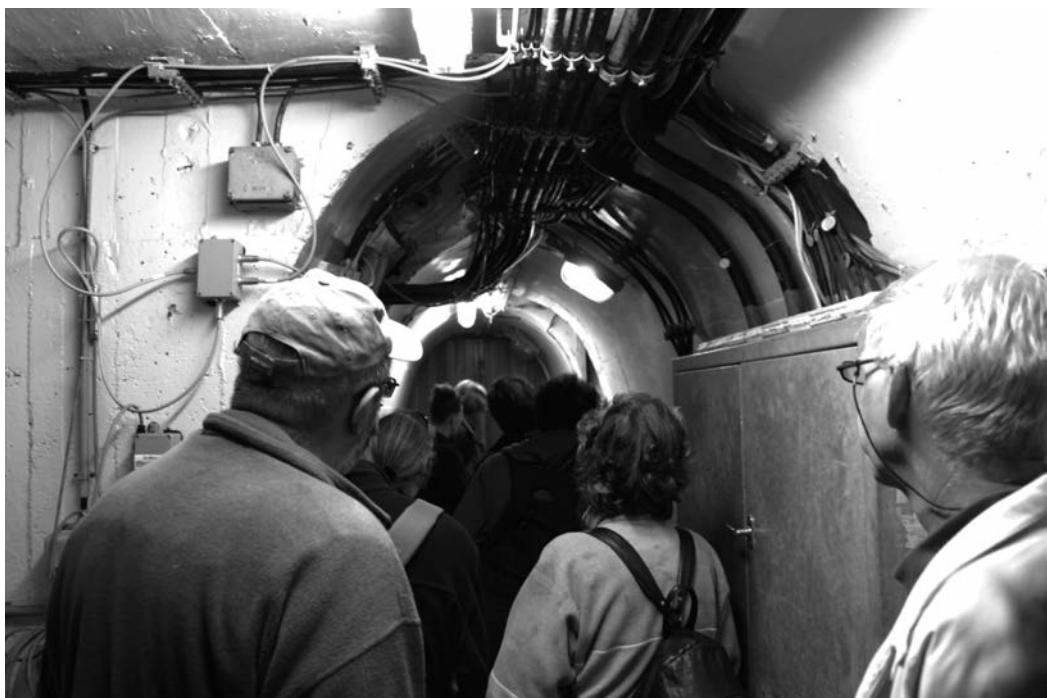
DAS VERKABELTE INNERE DER MAUER. FOTO: DAVID HALSER
